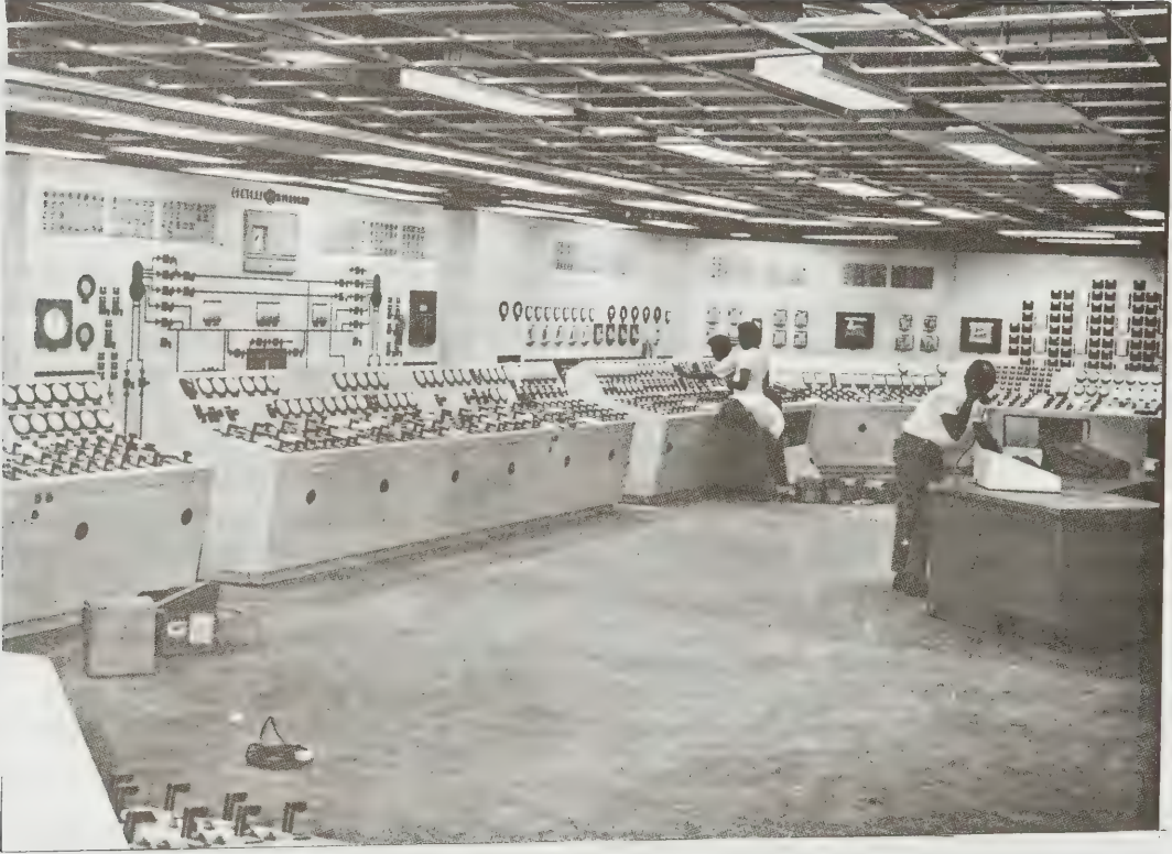
படம் 45. தாராயூர் அணுவின் நிலையக் கட்டுப்பாட்டு அறை.
